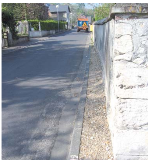
Trottoir quasi inexistant Source : Cete Normandie Centre
