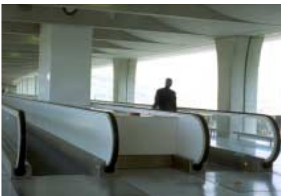
Trottoirs roulants - Aéroport de Paris CDG 2C.
