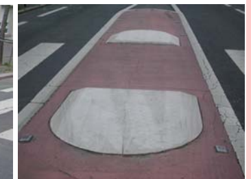
16 : Terre-plein central Manque les bandes d'éveil de vigilance
