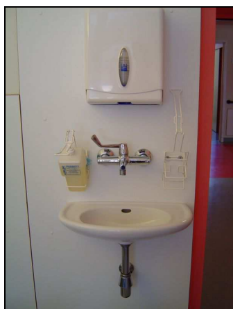
Lave-main avec robinetterie de préhension aisée.
