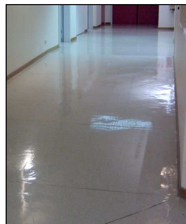
Finition trop réfléchissante
