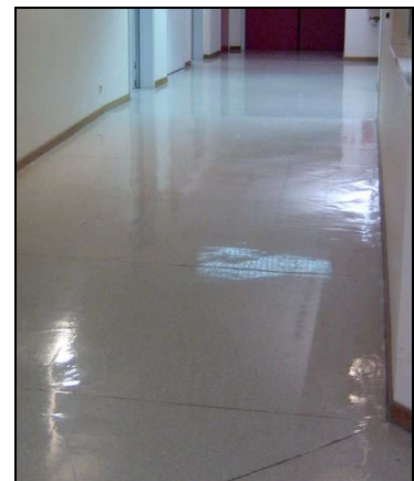
Finition trop réfléchissante
