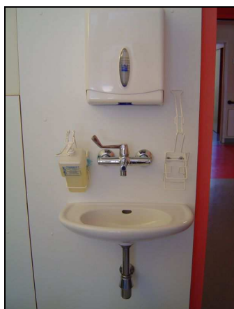
Lave-main avec robinetterie de préhension aisée.
